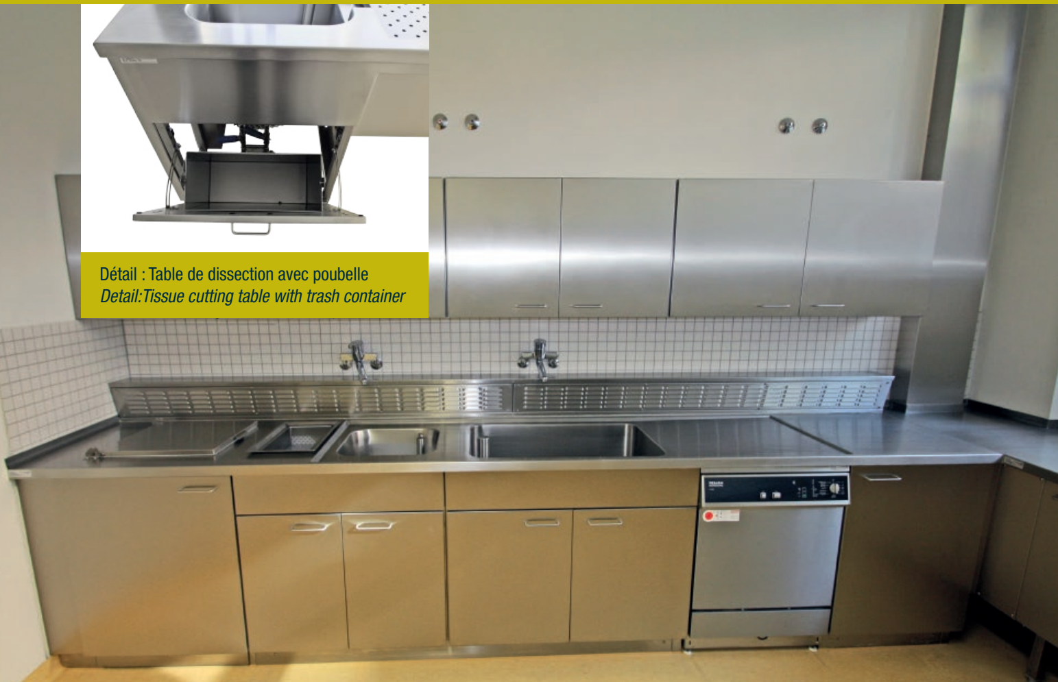
Plan de travail avec meuble haut, ventilation arrière, machine à laver de laboratoire, petit et grand évier, bac récupérateur de déchets liquides (formol) et poubelle Work bench with wall mounted cabinets, Back draft ventilation, laboratory dish washer, one small and one large basin, formalin discharge and trash container.
